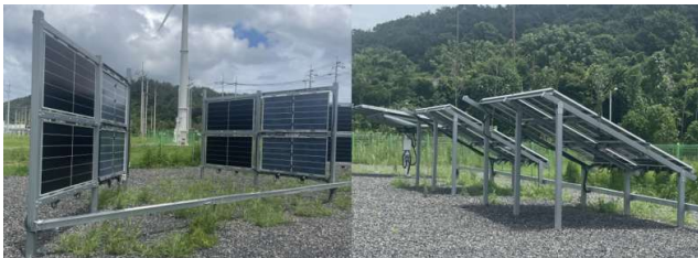
그림 2 태양광발전 실증 단지 Fig. 2 Photovoltaic Demonstration Site
